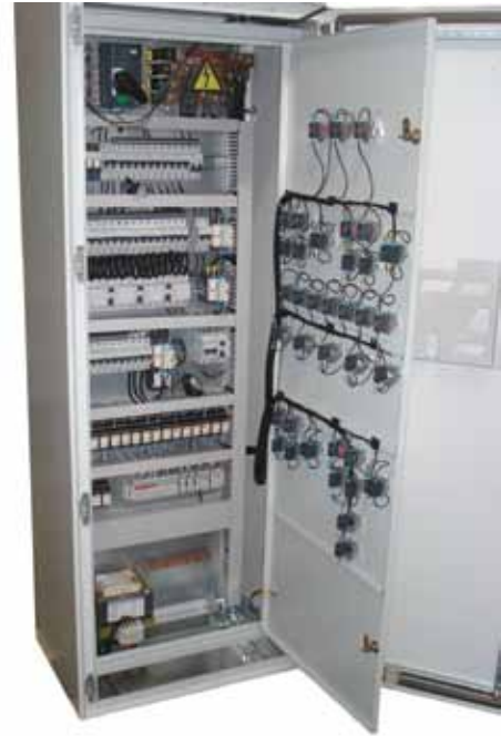
Figura 3. Tablero con doble puerta
