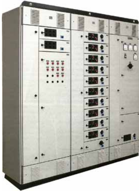
Figura 5. Tablero tipo CCM
